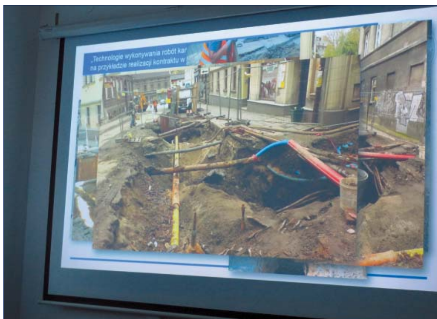
Jeden ze slajdów prezentacji, przedstawiający gęstość kolizji z innymi sieciami podczas budowy kanalizacji
