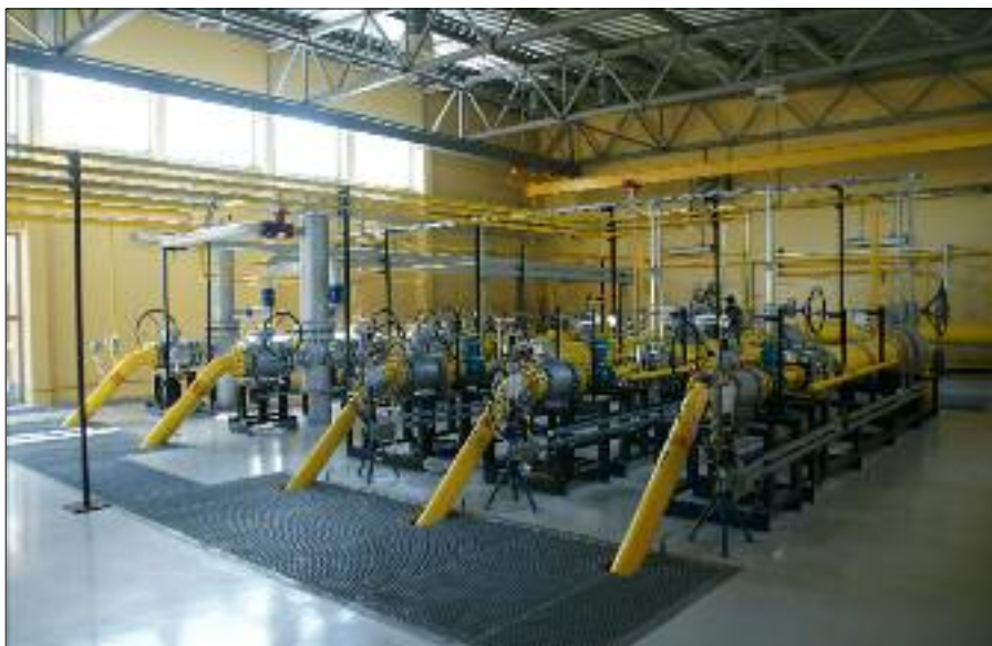
Widok części redukcyjnej stacji Kraków–Zawila
