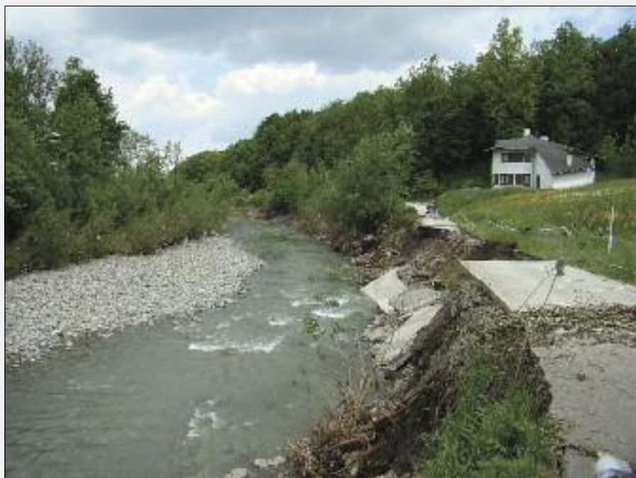
Zniszczona droga dojazdowa do wsi, rzeka Biała Tarnowska–Kąclowa
