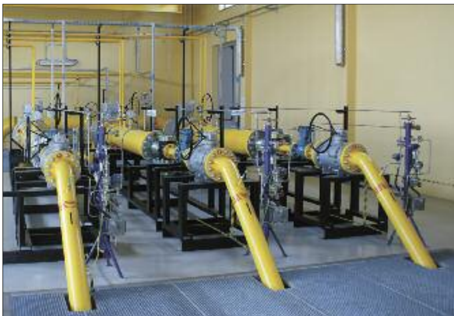
Ciągi redukcyjne z widocznymi pneumatycznymi jednostkami wykonawczymi systemu LC-21
