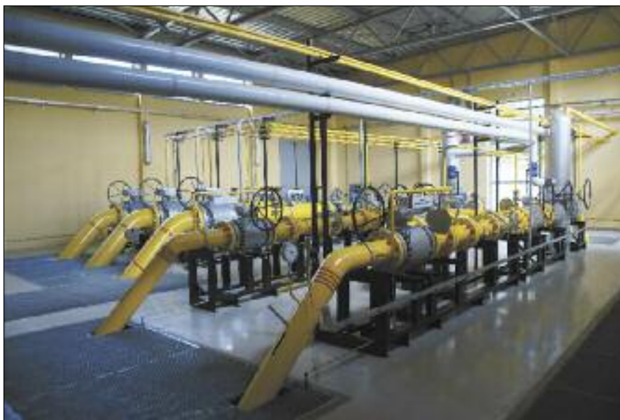
Ciągi pomiaru technologicznego DN 200
