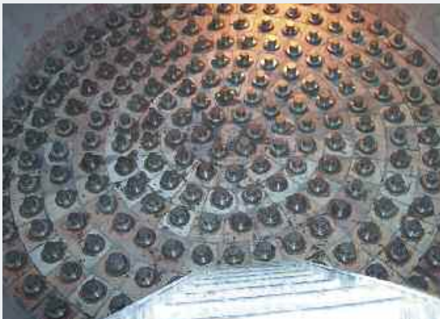
STACJA TERMICZNEJ UTYLIZACJI OSADÓW – DNO PIECA, DYSZE
