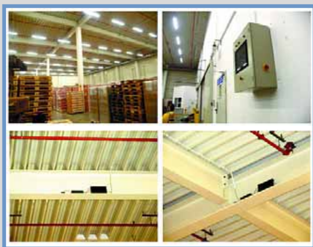
Rys. 5. System pomiarowy w hali magazynowej. Widoczna jednostka centralna z monitorem oraz zainstalowane czujniki odkształceń i temperatury wraz z modulem przetwarzania
