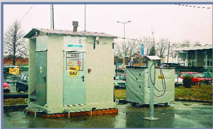
Stacja w Rzeszowie
