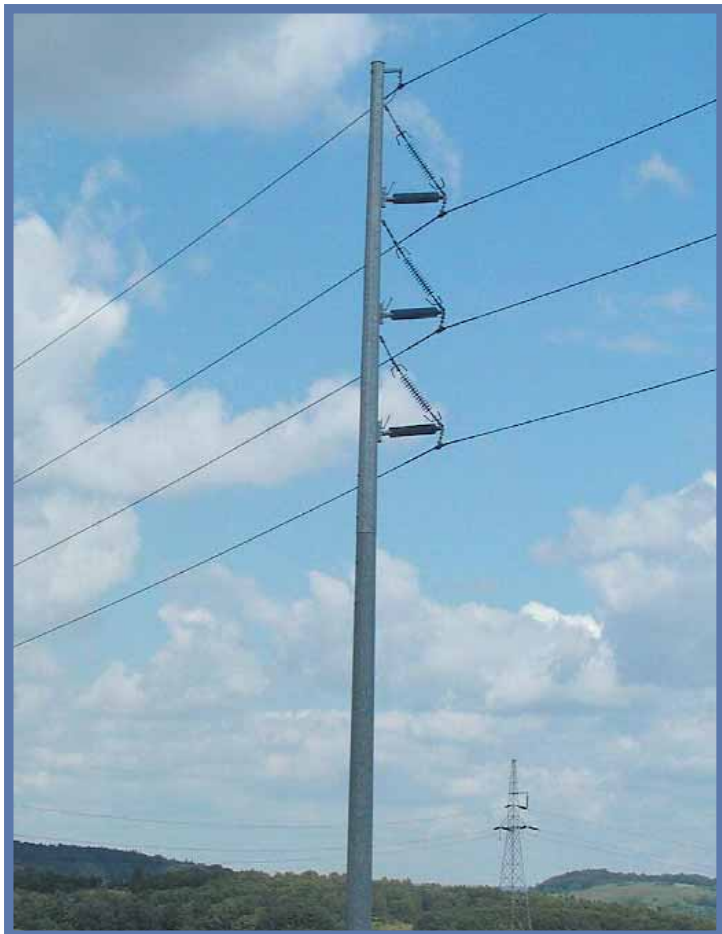
Linia 110 kV Kampus (kierunek Skawina). Oddanie do eksploatacji: kwiecień 2003 r.
