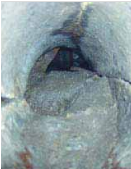
Charakterystyczne uszkodzenia kanałów.
