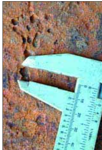
Charakterystyczne uszkodzenia korozyjne wewnętrznej ściany rury stalowej
