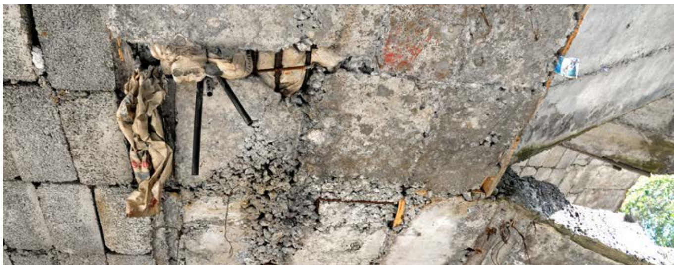
Fot. 12. Fragment stropu na tej samej budowie – oprócz raków w betonie widoczne ciała obce
