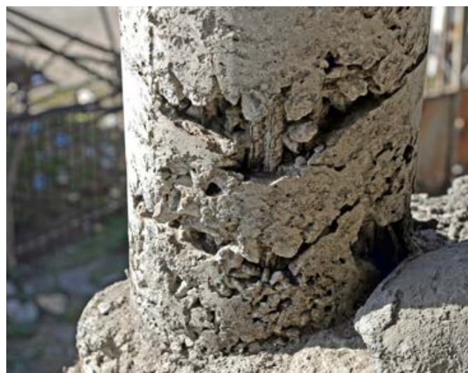
Fot. 11. Budowa w mieście Weldiya (Etiopia) – głębokie raki u podstawy żelbetowego słupa
