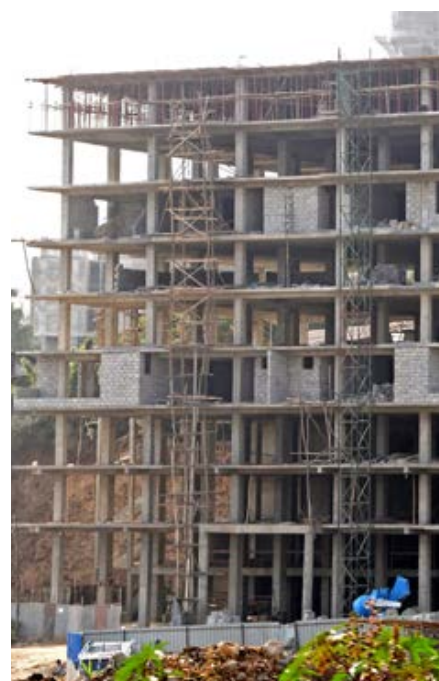
Fot. 13. Addis Abeba wielokondygnacyjny budynek szkieletowy bez ścian usztywniających (widoczne ściany wypełniające wykonano z betonu lekkiego)
