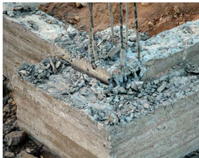
Fot. 5. Sharm el Sheikh – zła jakość betonu fundamentów
