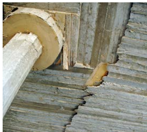
Fot. 3. Sharm el Sheikh, strop widziany od spodu – uskok jako skutek wadliwego deskowania
