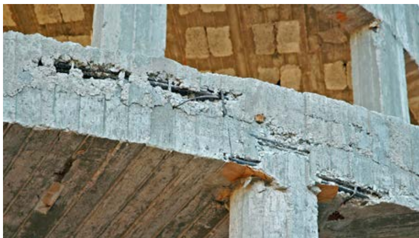
Fot. 2. Rozległe, głębokie raki w konstrukcji z fot. 1
