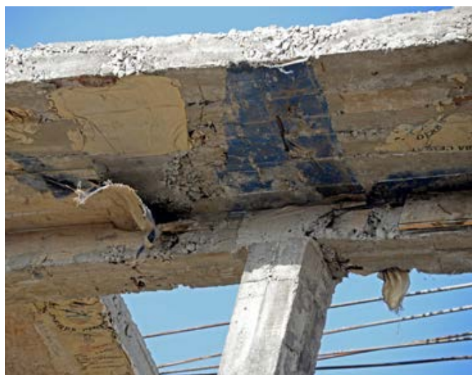
Fot. 10. Budowa w mieście Shashamane (Etiopia) – widoczne liczne rozległe raki oraz ciała obce
