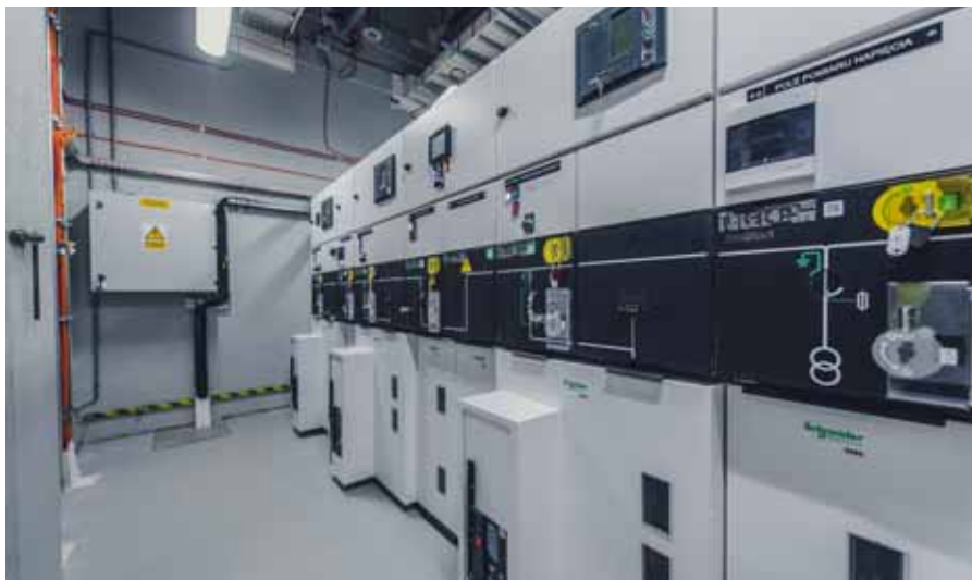
Stacja transformatorowa ST1.
