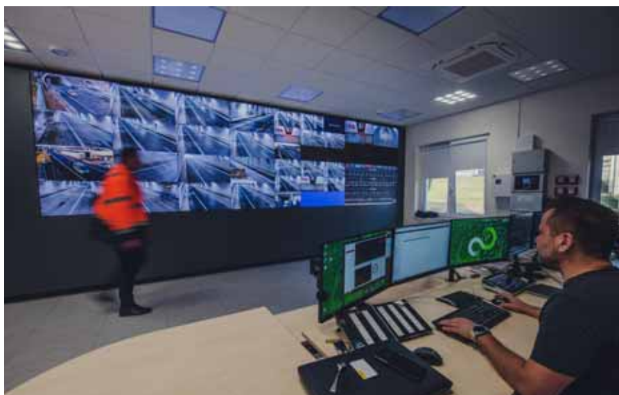
Centrum zarządzania tunelem
