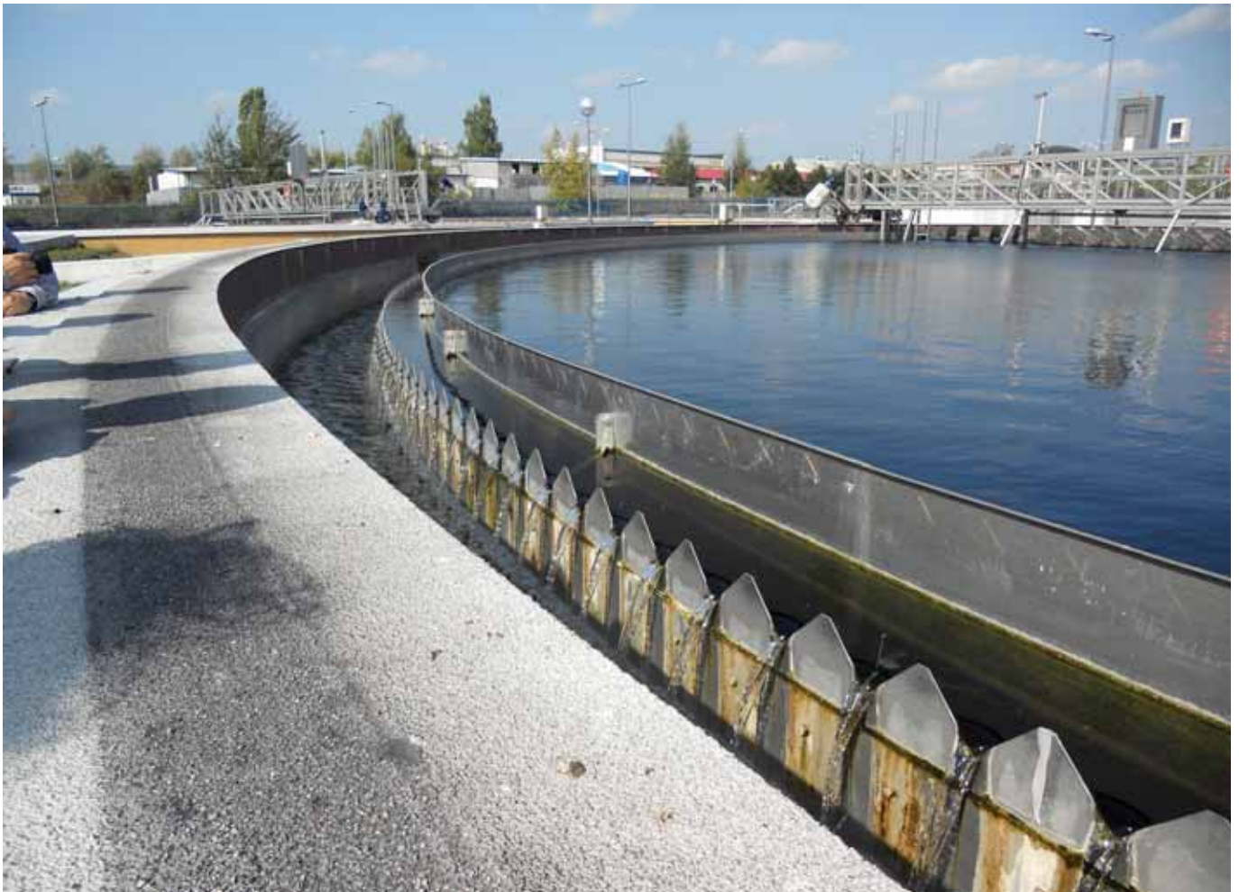
Przelewy pilaste do odprowadzenia ścieków oczyszczonych z osadnika
