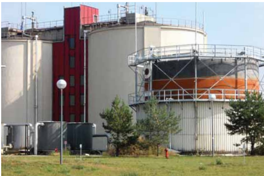
Komory fermentacyjne osadów ściekowych w dużej oczyszczalni
