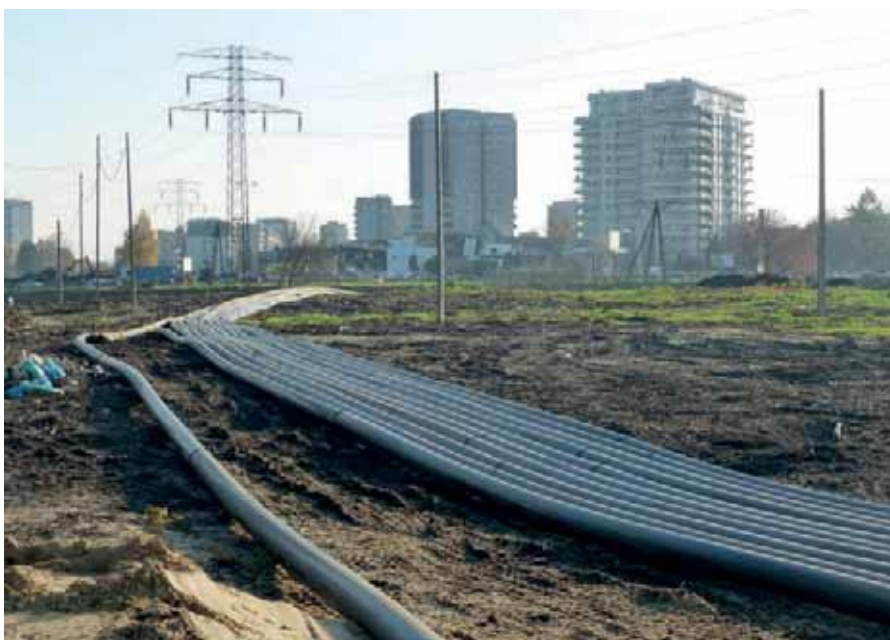
„Otwarta przestrzeń” po skablowaniu linii WN (odc. Opolska - Pachońskiego)
