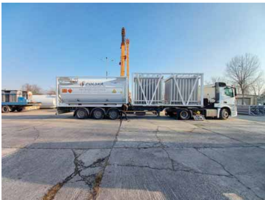
Fot. 6 Infrastruktura LNG na potrzeby zasilania awaryjnego (zestaw parownic i zbiornika cysterny w ramach kontenerów ISO 20 ft.)
