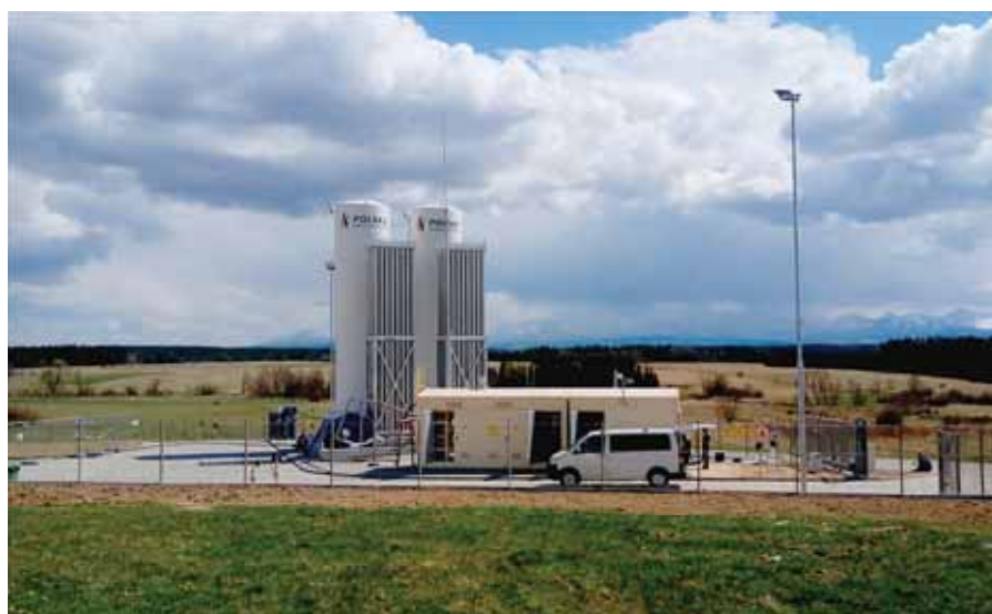
Fot. 4 Stacja regazyfikacji LNG w Jablonce na Orawie
