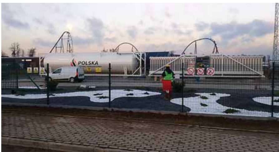
Fot.2 Stacja regazyfikacji LNG w miejscowości Zator (w tle park rozrywki Energylandia)
