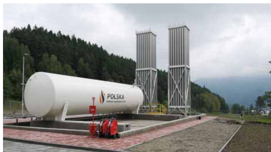
Fot. 5 Stacja regazyfikacji LNG w Rytro
