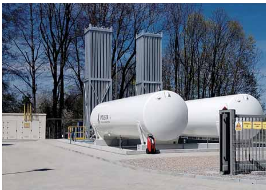
Fot. 3 Stacja regazyfikacji LNG w Białce Tatrzańskiej
