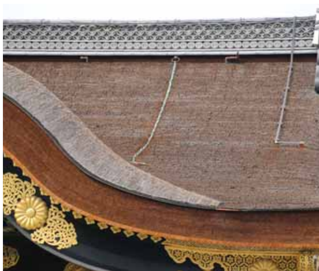
Instalacja odgromowa na pokryciu
