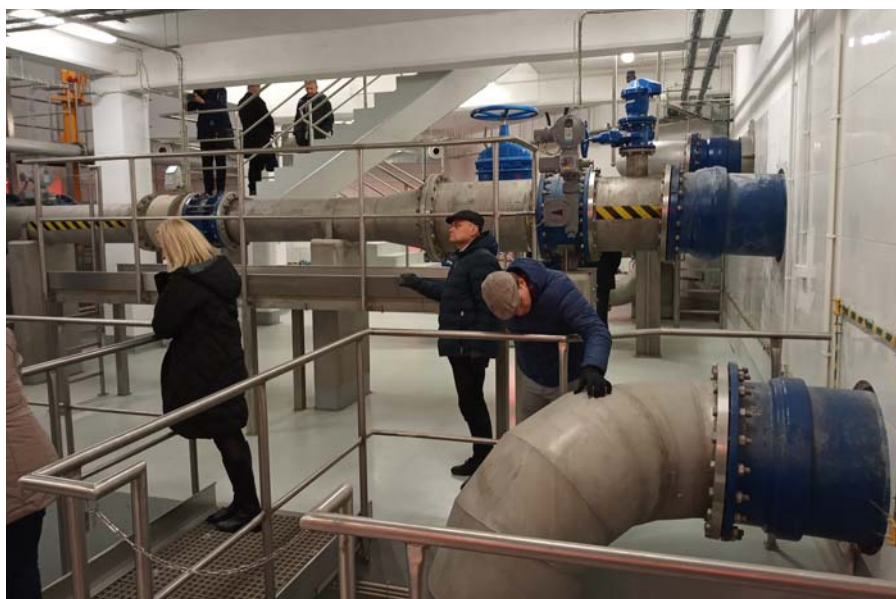
Rurociągi technologiczne w komorze zasuw
