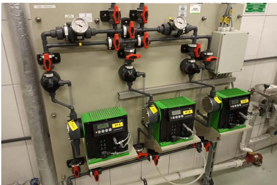
Pompy dawkujące podchloryn sodu
