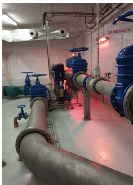
Hydrofornia Górka Narodowa w komorze zasuw
