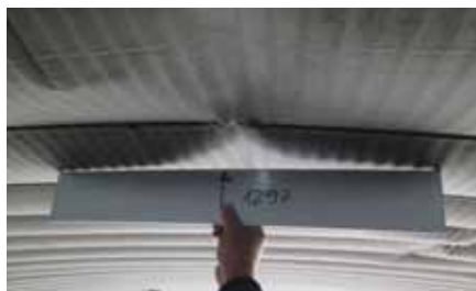
Rys. 4. Zniszczone blachy falde w wyniku wybuchu wewnątrz hali.
