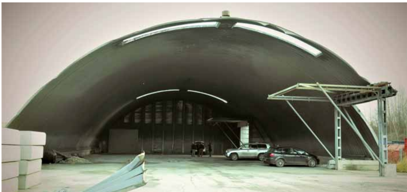
Rys. 1. Część hali pozostawiona do oceny biegłego
