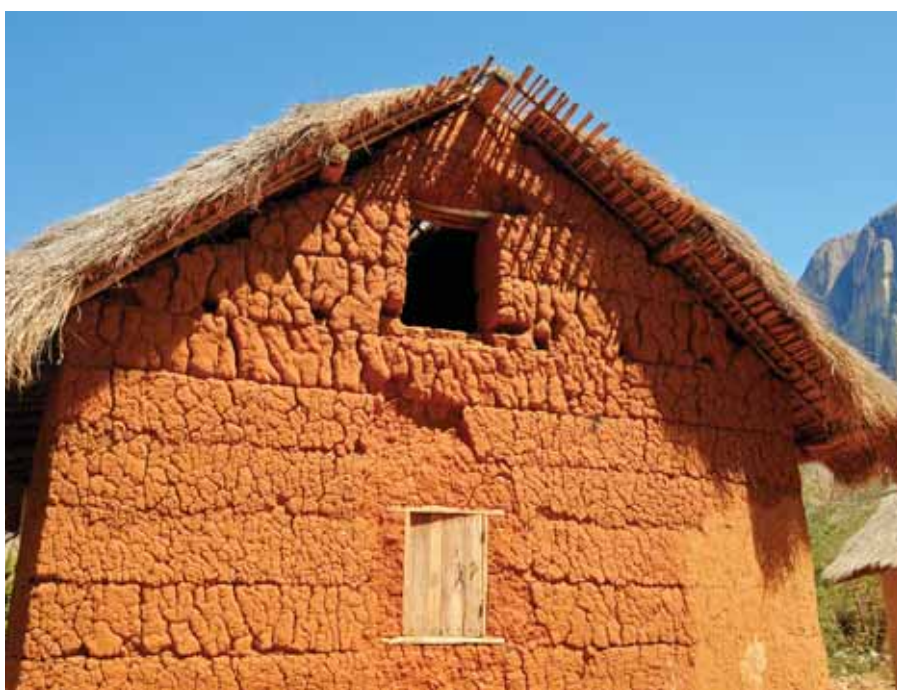
Fot. 20. Erozja muru związana z uszkodzeniem strzechy pokrycia dachowego
