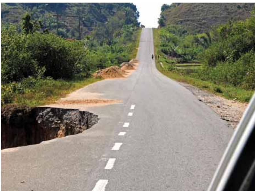
Fot. 27 Powstała dwa lata wcześniej wyrwa w jezdni
