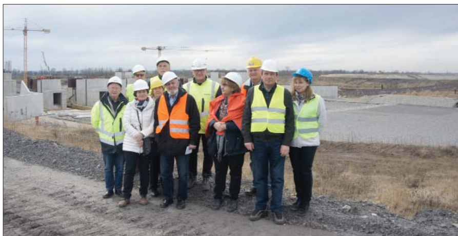
Członkowie OROZ MOIIB w Krakowie podczas zwiedzania Budowli Przelewowo-Spustowej - widok na obiekt od stanowiska dolnej wody. W pierwszym rzędzie od lewej: Tadeusz Smagowicz, Janina Wisor-Pronobis, Stanisław Abrahamowicz, Elżbieta Jastrzębska, Marian Janusz, Beata Szubarga, W drugim rzędzie: Jerzy Rasiński, Waclaw Marcjan, Zbigniew Franczak, Andrzej Ciasnocha.
